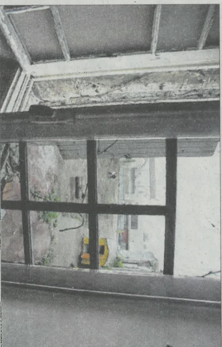
Abandonnée depuis 20 ans, l'ancienne clinique est régulièrement squattée. Elle a aussi été victime de deux débuts d'incendie.
