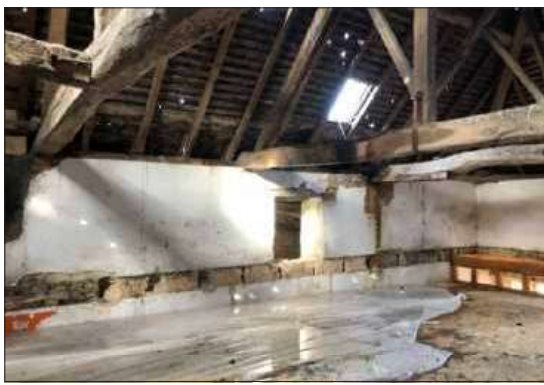
La toiture, trouée, doit être refaite en début d'année prochaine. Photo CL
